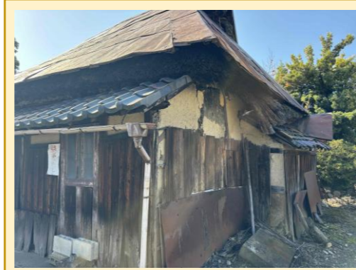
中心市街地（東地区）にある木造茅葺の空き家。火災延焼の危険有
